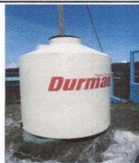
Foto 6: tanque de agua colocado para depositar agua.
